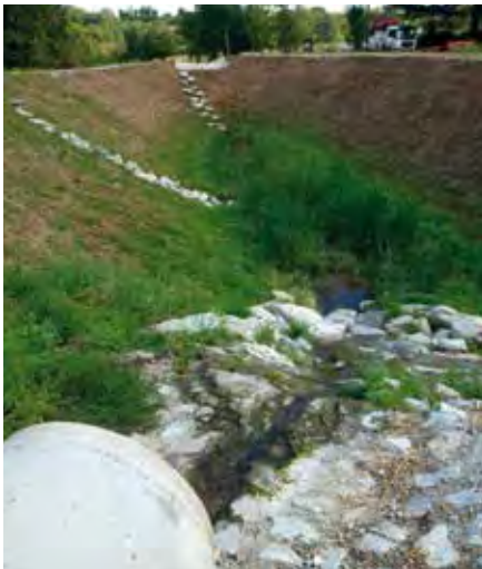
Sur la commune d'Orliénas, la création de 2 bassins de stockage temporaire des eaux pluviales permet désormais de réguler leurs rejets au Merdanson d'Orliénas et ainsi de prévenir le risque d'inondation vers l'aval.
